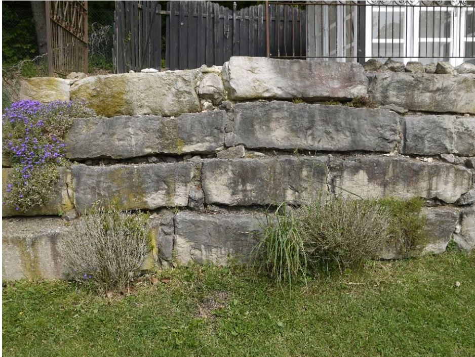
Abb. 6: Natursteinmauer, zum Großteil verfugt, jedoch mit einzelnen Höhlungen
