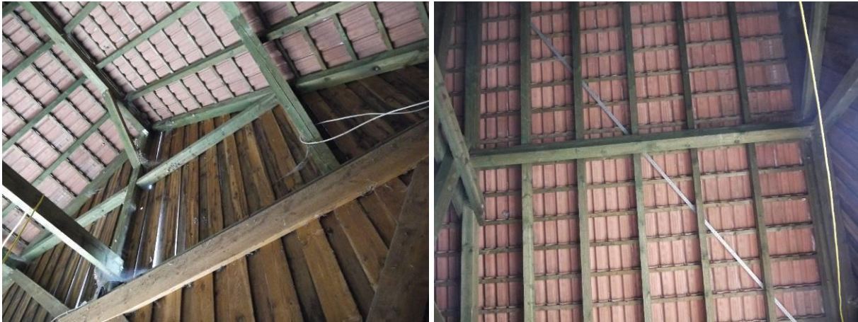
Abb. 8: Satteldachgebäude mit kleinen Spalten.
